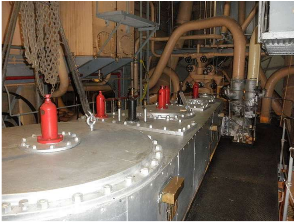
La machine du Liberty ship Jeremiah O'Brien vue de dessus. On distingue le haut des cylindres et des tiroirs de distribution (photo Zandcee)
